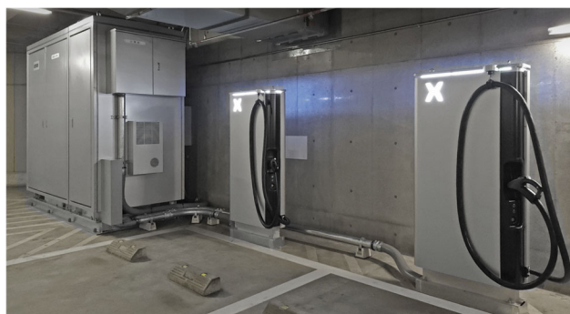
■2023年12月20日オープン予定の EV チャージステーション
